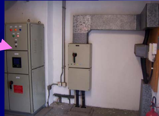
電網介面設備
